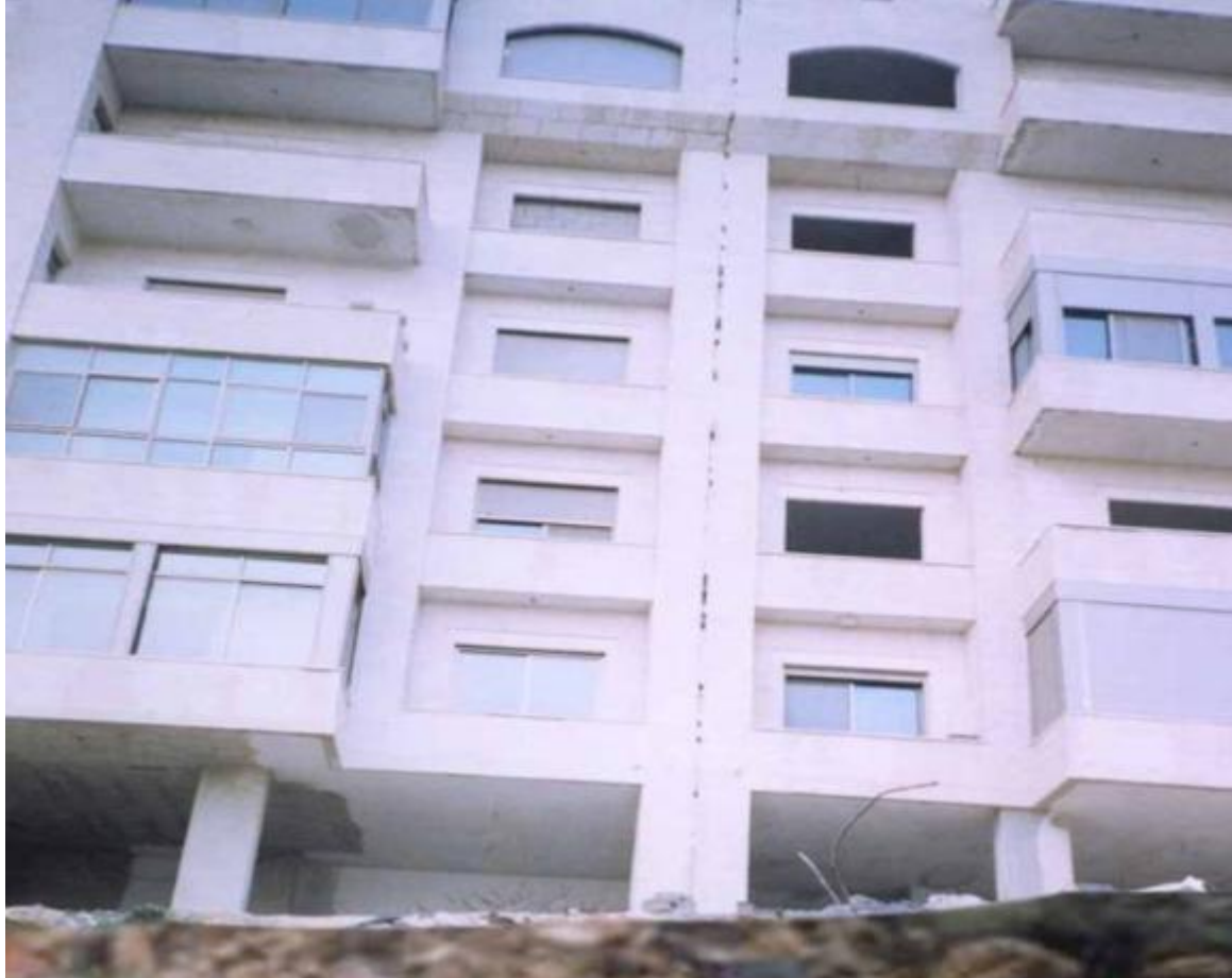
فواصل التمدد في أنماط المباني الدارحة محلياً Jalal Al Dabeeq, UPDRR center. NNU, PS
